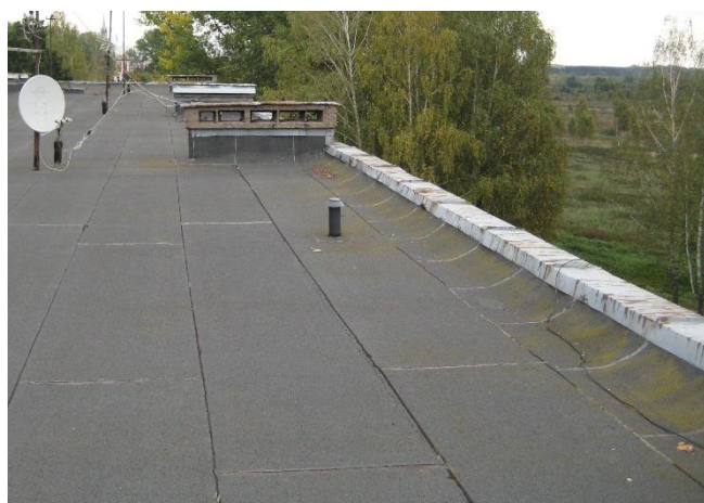
6 pav. Stogo būklės fragmentas.
