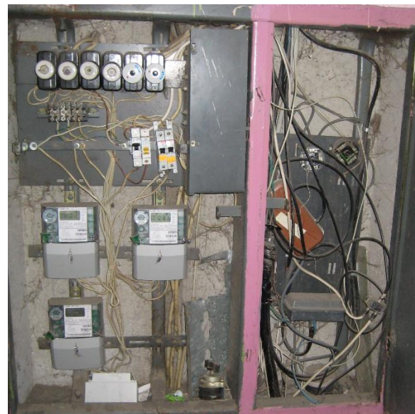
4 pav. Butų el. apskaitos skydinių būklės fragmentas.
