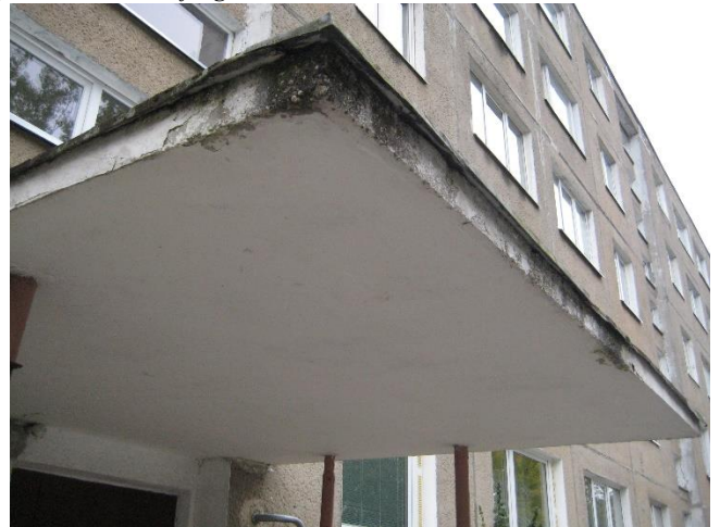
9 pav. Įėjimo stoginių būklės fragmentas.
