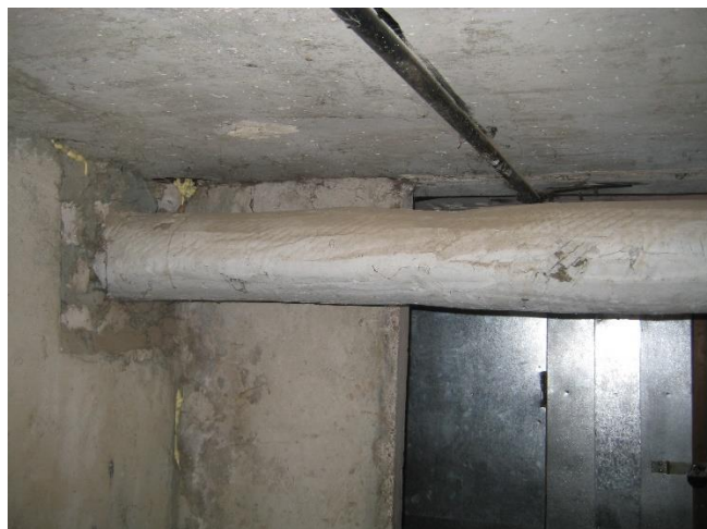
2 pav. Magistralinių vamzdynų su asbesto izoliacija fragmentas.
