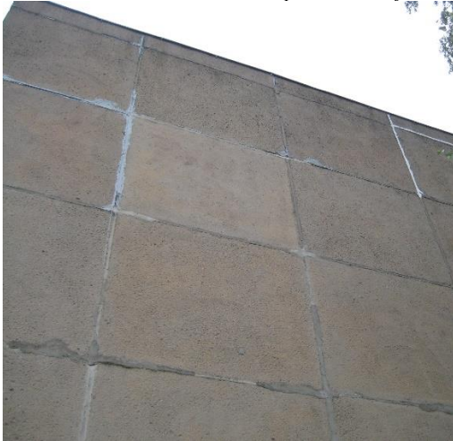
8 pav. Pastato blokų siūlių būklės fragmentas.
