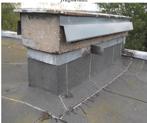
5 pav. Ventiliacijos šachtų būklės fragmentas.
