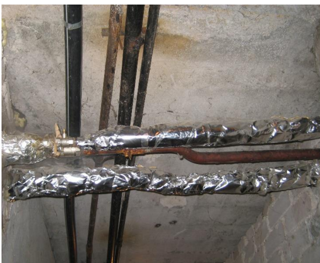
3 pav. Magistralinių vamzdynų su asbesto izoliacija fragmentas.
