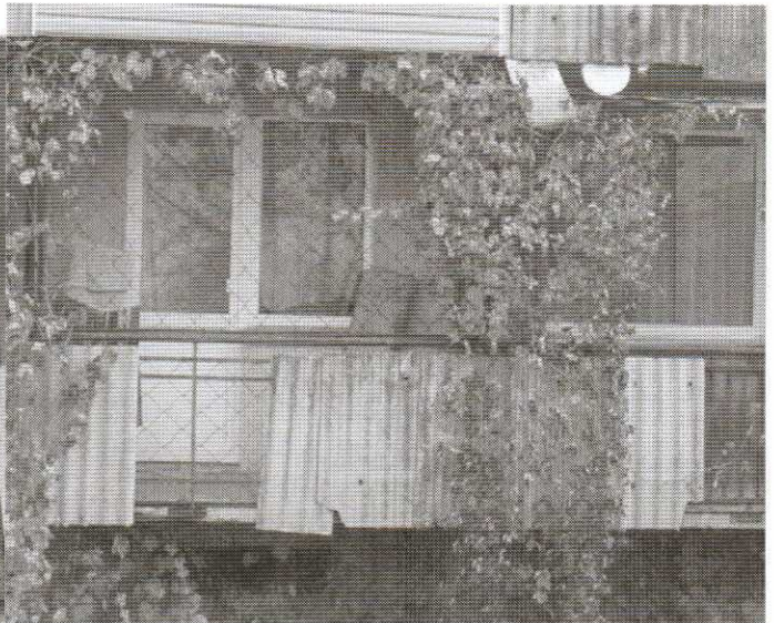
6. Balkonų turėklų būklės fragmentas.
