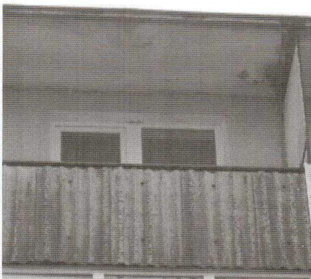
5. Balkonų būklės fragmentas.
