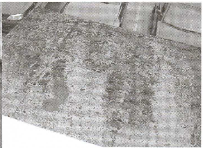
2 pav. Įėjimo stoginių dangos būklės fragmentas.
