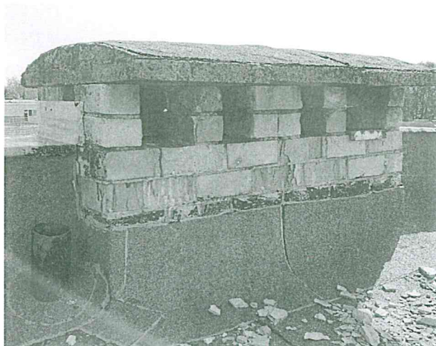
2 pav. Ventiliacijos kaminėlių būklė.
