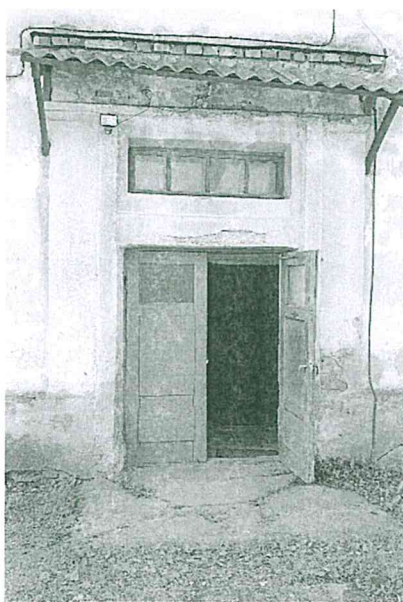
9 pav. Pastato laiptinės durų ir laiptinės langų būklė.
