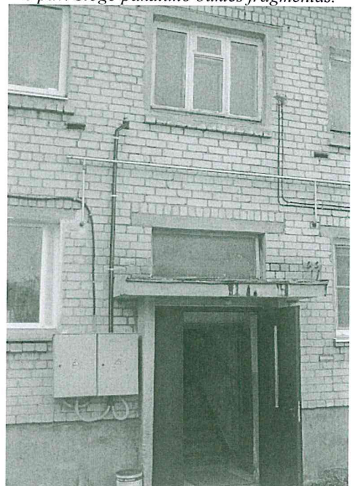
10 pav. Laiptinės, įėjimo durų ir stoginės būklė.
