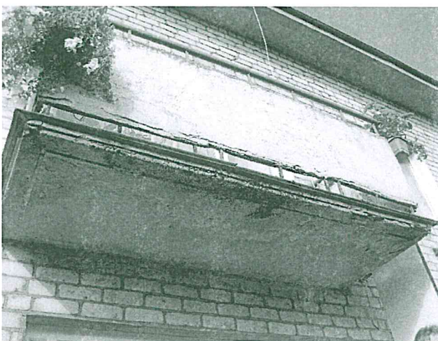
5 pav. Balkonų perdangos ir turėklų būklės fragmentas.
