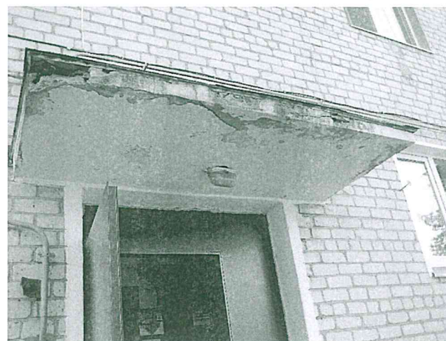
6 pav. Įėjimo stoginės gelžbetonio konstrukcijos būklės fragmentas.
