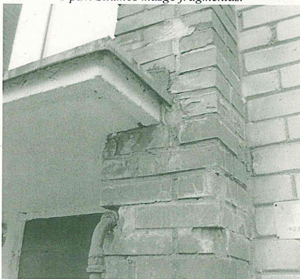
3 pav. Plytų mūro pažeidimų fragmentas.
