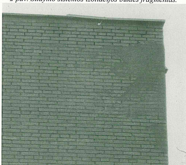
4 pav. Plytų mūro pažeidimų fragmentas.
